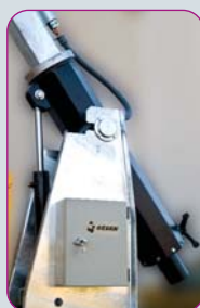
Cuadro eléctrico de elevación (versión hidráulica)
